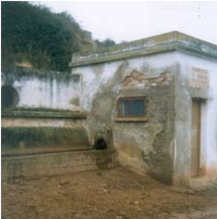
Depósito Mal Protegido
